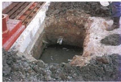
地下水位が高く植穴に水が溜まっている
