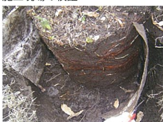
シートを剥がした根の状況
