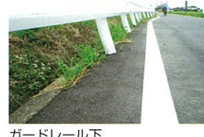
ガードレール下 ハシピタン未施工箇所（三重県鈴鹿市）
