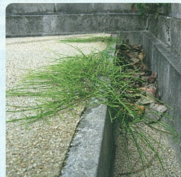
ハシピタン未施工
